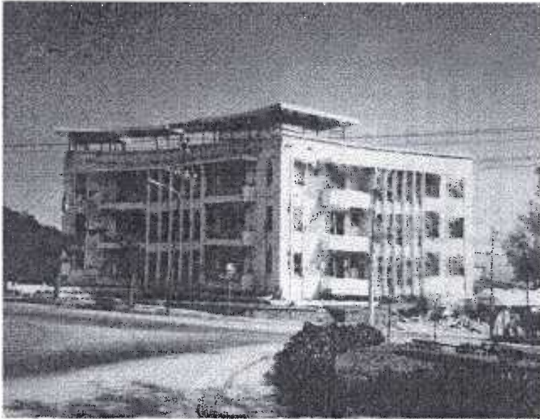
FOTO N° 17: Apartamentos San Francisco. Note la pérdida total del primer nivel.
