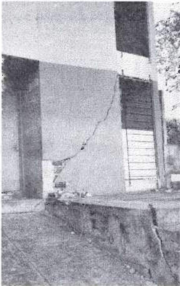
FOTO N° 19: Falla en la fachada por corte con poca densidad de muros.
